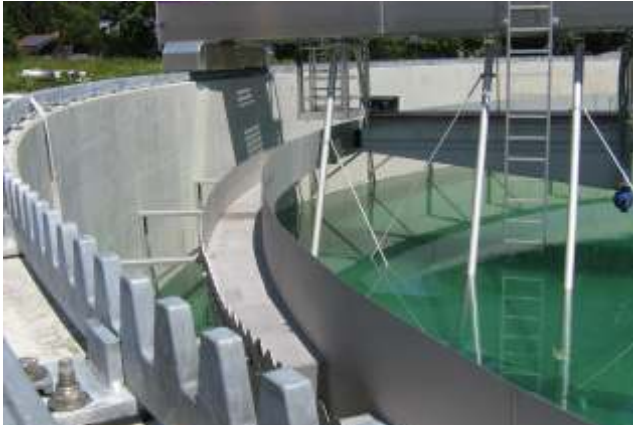
Abbildung: Ablaufrinne des Nachklärbeckens mit Räumerbrücke, Zahnschiene im Vordergrund
