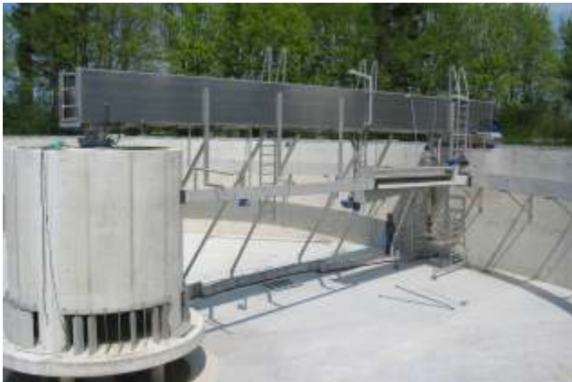
Abbildung: Leeres Nachklärbecken mit zentralem Einlaufbauwerk und Räumerkonstruktion
