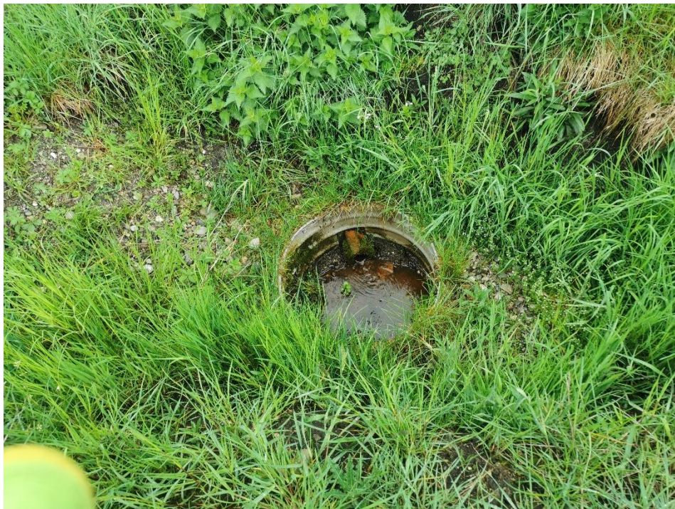
Abbildung 2: Drainagerohr in der Mitte des Feldes
